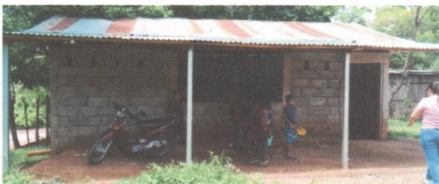
Foto1: Se observa la necesidad de sustituir la cubierta de lámina
