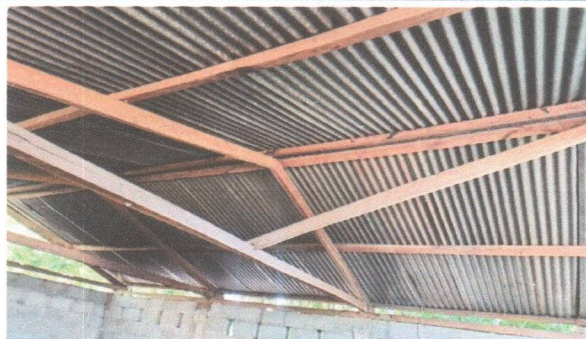
Foto 2: Se observa la necesidad de sustituir la estructura de techo
